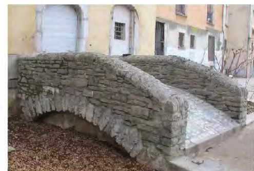
Le Verderet s'écoulait au pied de la rue Chenoise. Au détour de la rue Saint-Jaime, on retrouve le Pont du Verderet, découvert sous des remblais par des membres de l'association. Photo D. P.
